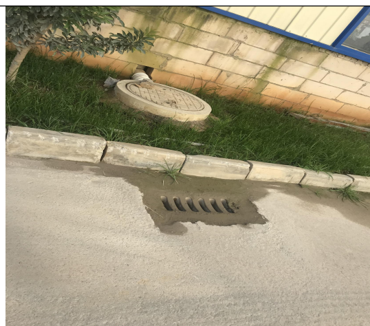
初期雨水收集池（5m 3 ）
