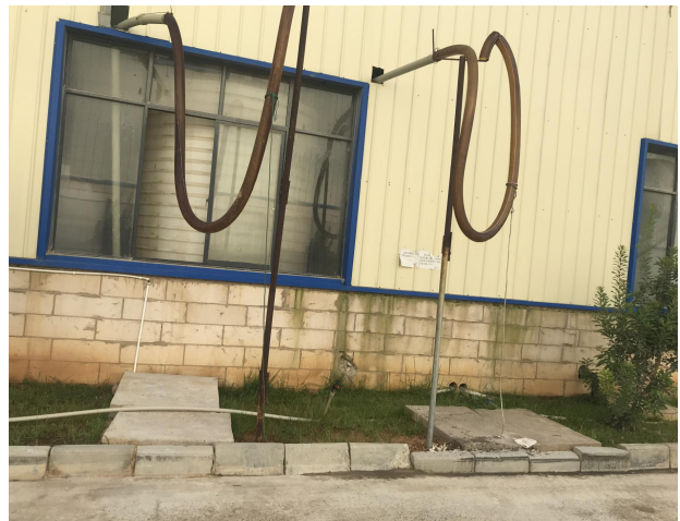
生产废水沉淀池
