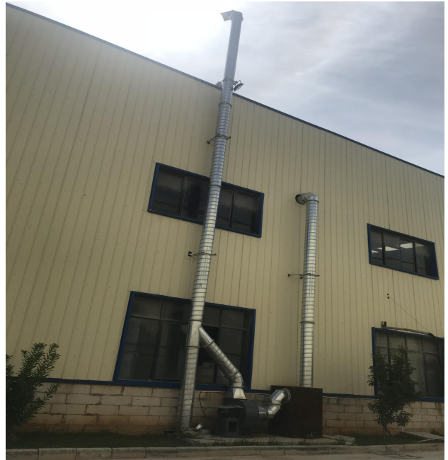
有机废气处置设施及排气筒
