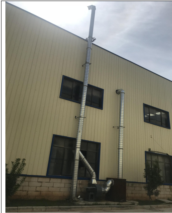
有机废气处置设施及排气筒
