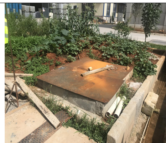
试验废水沉淀池
