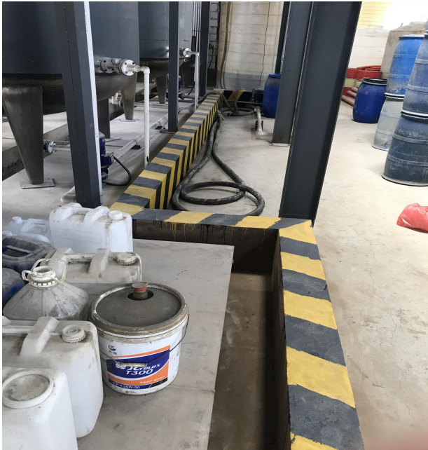
反应釜下方围堰及导流沟
