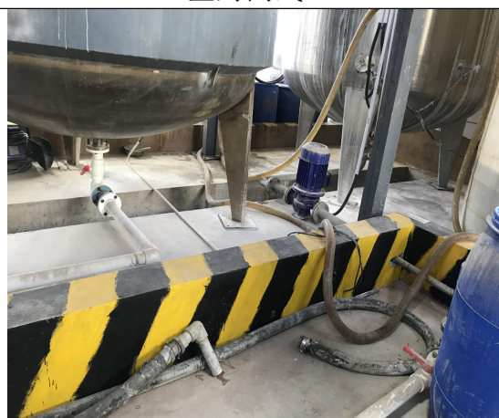
反应釜下方围堰及导流沟
