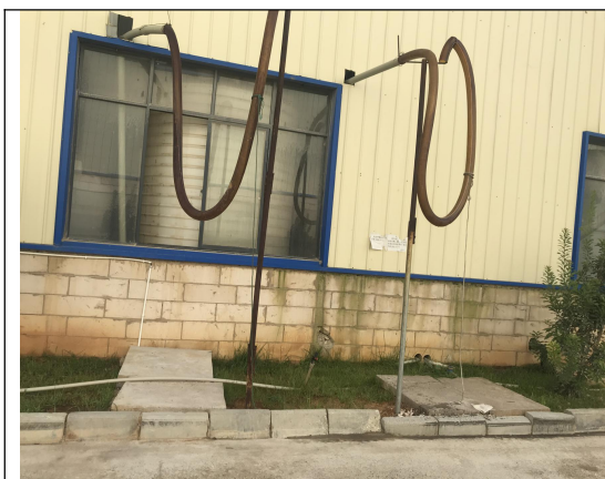
生产废水沉淀池（2个，5m/个）
